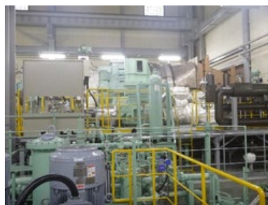
写真 4-2-3 タービン・発電機
